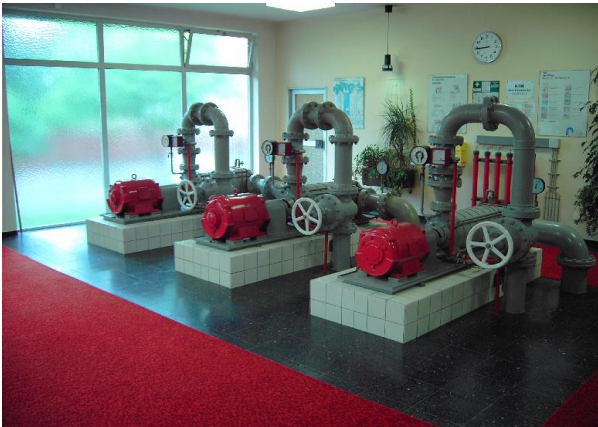
Blick auf die Hauptpumpenanlage
