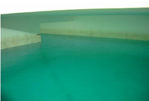
Blick in die Wasserkammer
